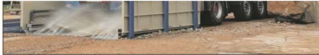
Moby Dick: Jeder Lkw, der das Gelände verlässt, muss durch die Waschanlage, damit über die Reifen kein Erdreich mit nach draußen gelangt.
